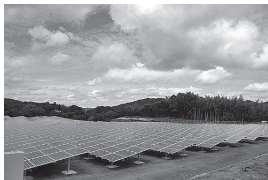
神在太陽光発電所
